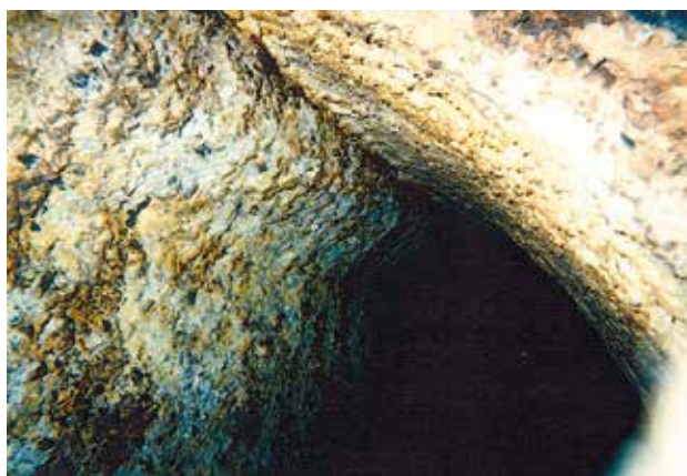
酸でぼろぼろになったコンクリート管 かん (下水道管: 直径2m)
