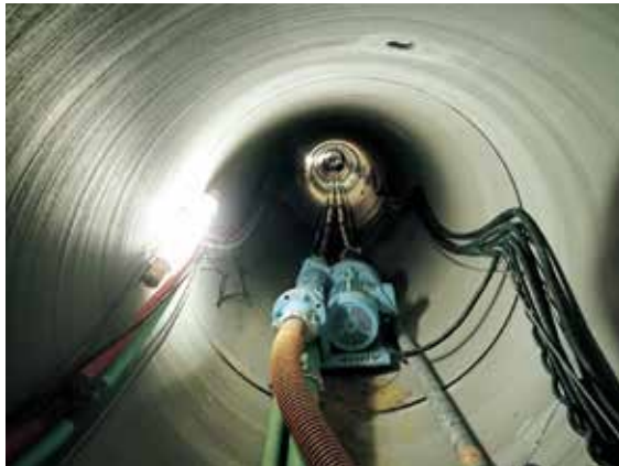
の だ なかしまおすいかんせん 2015年(平成27年) 野田・中島汚水幹線工事 ちよっけい 直径1.5mの下水道トンネル工事
