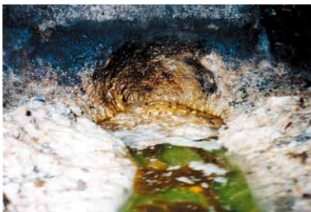
油でべとべとになった管 かん (下水道管: 直径20cm)
